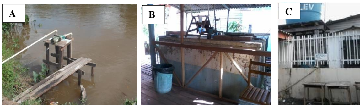
Figura 15. Abastecimento de água na EE Francisco Filho, comunidade de Anauerapucu AP. (A). Captação de água, diretamente do Rio Anauerapucu; (B). Sistema de purificação; (C). Caixa d'água para armazenamento.
