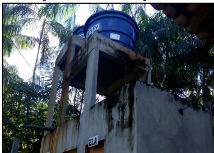
Figura 28 – Banheiros e caixa d'água da escola
