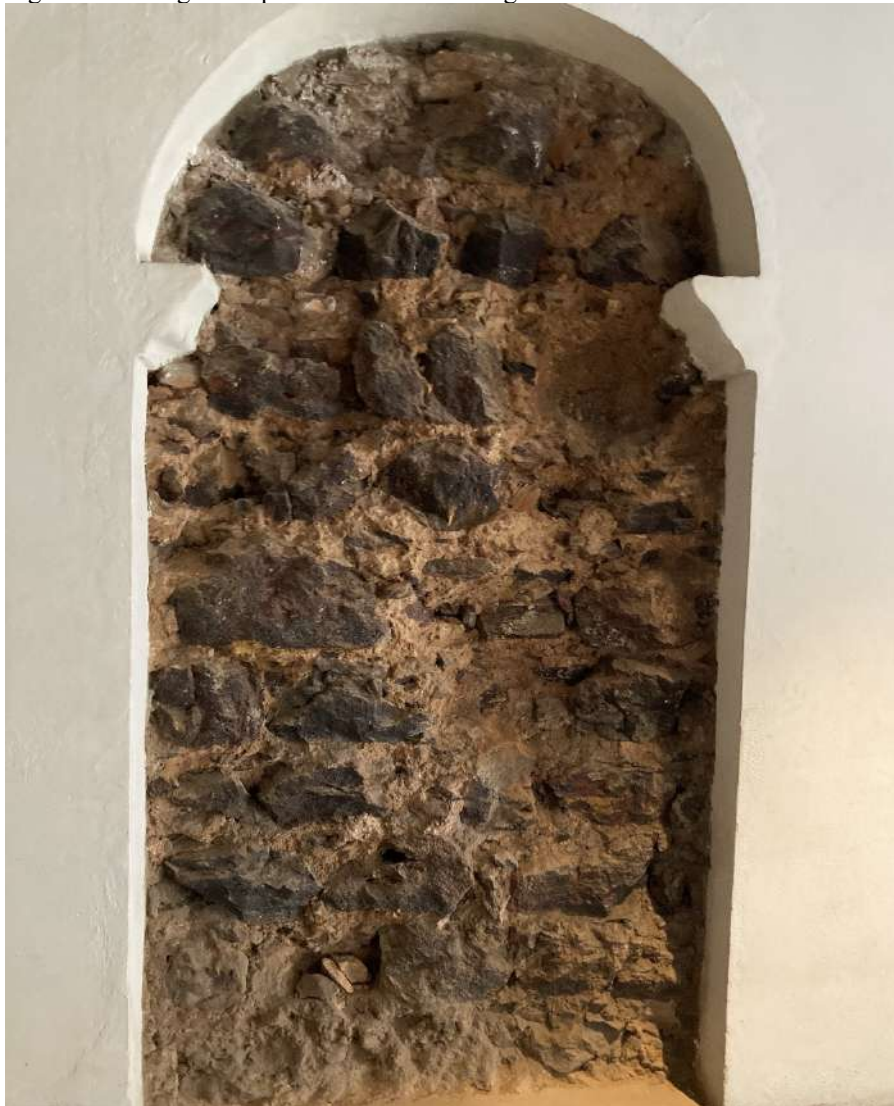
Figura 11 – Imagem da parede interna do Colégio de Santo Alexandre construída em pedra e cal.
