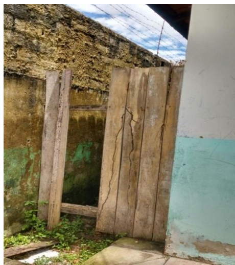
Imagem 20 Isolamento inicial do bloco de sala de aula destruído
