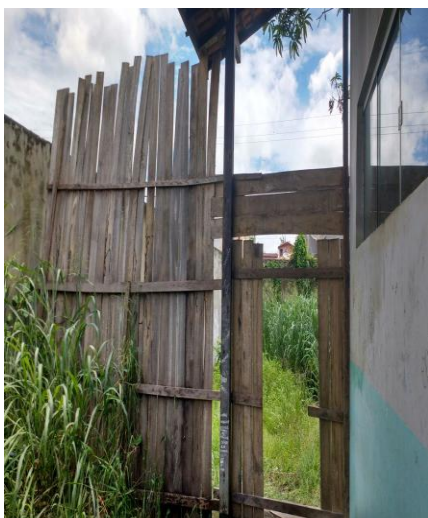
Imagem 19 Isolamento final do bloco de sala de aula destruído
