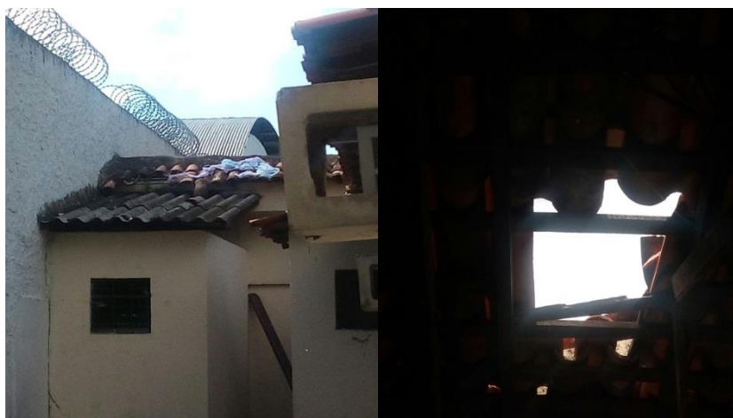
Figura 2 - Fotos de uma 'Teresa' 25 e do destelhamento do quarto realizado para a fuga de dois jovens
